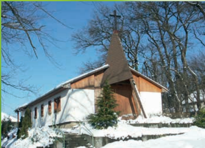
Die beschädigte Holzkirche Piliscsaba
